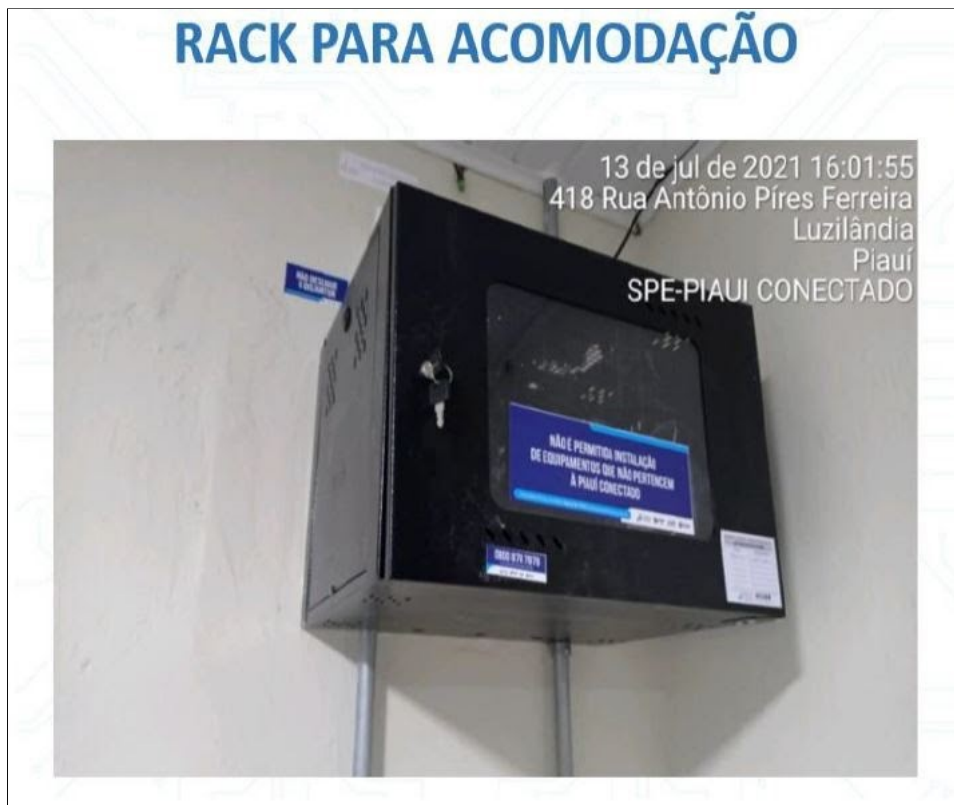
Figura 12 - Vista do rack que a SPE PIAUÍ CONECTADO S/A instalará dentro de cada Ponto de Acesso de Governo - PAG do TJPI
